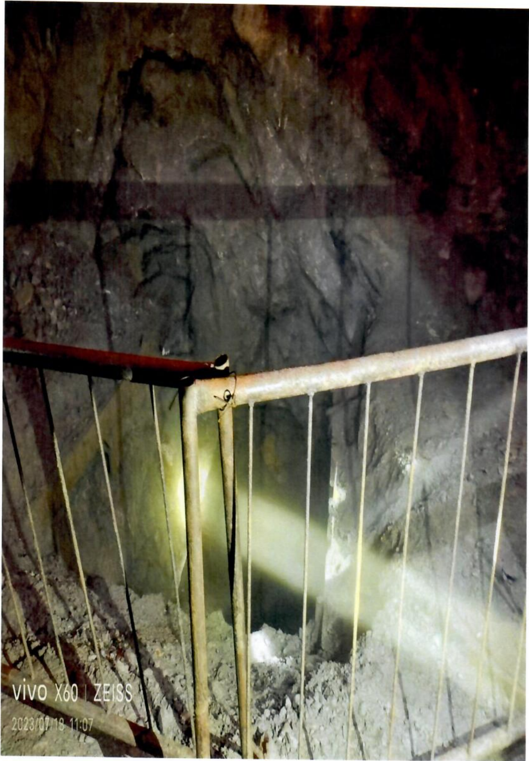
图 2 “7·1”事件事发溜井口未采取有效防护
